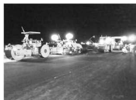
(老朽化した滑走路舗装の改良)
