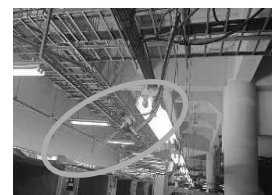
ランパサイトの空調装置(ミスト) (中部空港)
